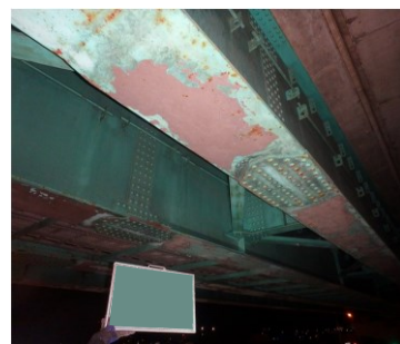
＜鋼桁＞ 経年劣化による塗膜の剥がれ
