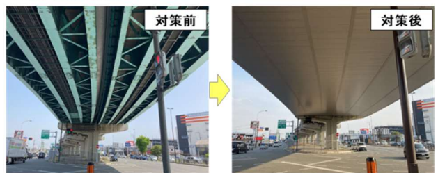
恒久足場による点検・補修の効率化 対策の状況(福岡高速)
