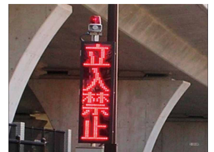
写真5-5-9 逆走感知システム設備
