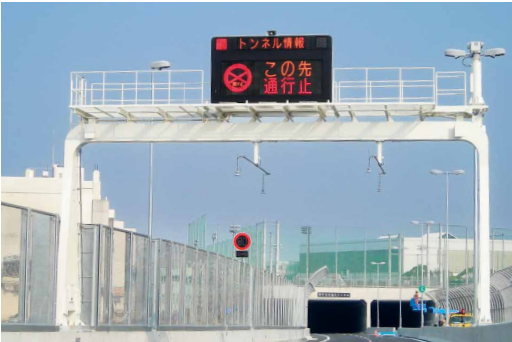
写真5-5-15 トンネル情報板
