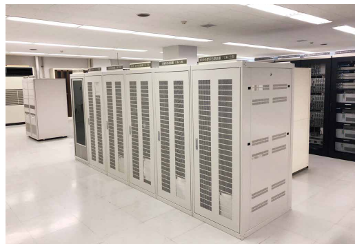
写真5-5-3 交通管制中央設備
