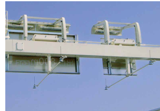
写真5-5-6 車両感知設備
