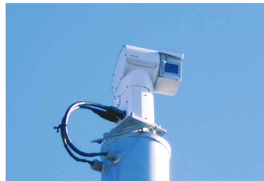
写真5-5-5 監視用カメラ設備
