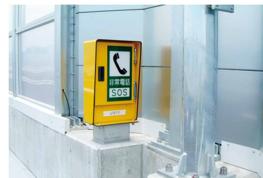
写真5-5-7 非常電話設備
