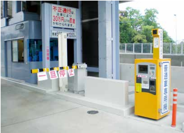
写真6-3-4 自動料金収受機(堤西料金所)
