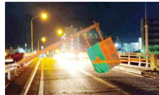
台風9号による案内標識柱の倒壊
