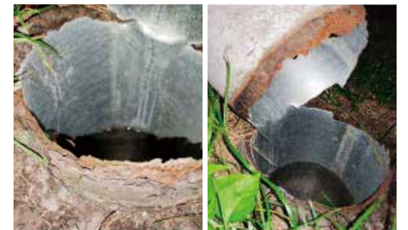
倒壊した案内標識柱の根元
