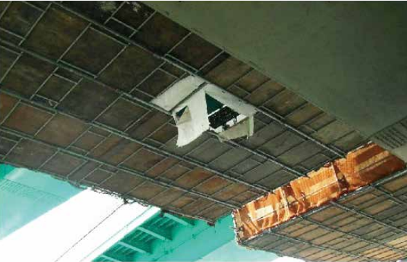
写真9-2-1 吊り足場(下面)破損状況
