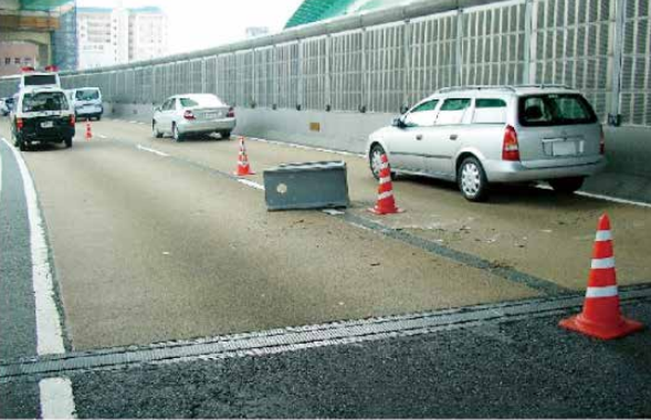
写真9-2-2 落橋防止ブラケット落下状況
