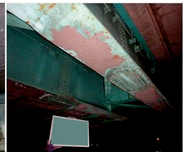
＜鋼製桁＞ 経年劣化による塗膜の剥がれ
