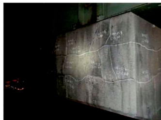
＜コンクリート橋脚（梁）＞ コンクリートのひびわれ
