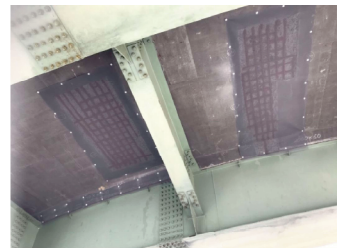
＜コンクリート床版＞ 疲労による損傷
