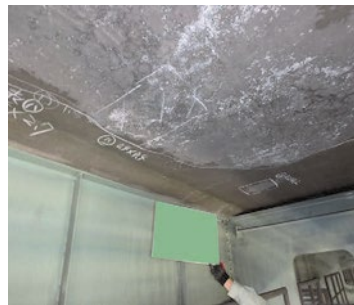
＜コンクリート床版＞ 疲労によるひび割れ・漏水
