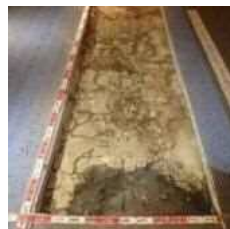
コンクリート床版の土砂化
