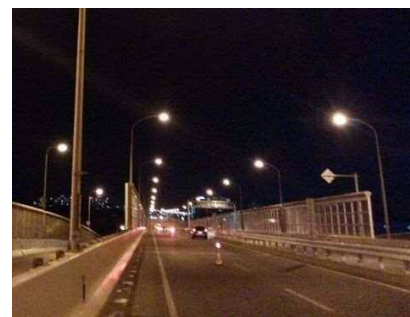
高圧ナトリウム照明 (福岡高速1号線名島付近)
