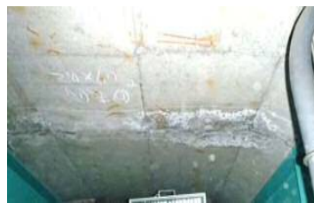
コンクリート床版下面のひび割れ
