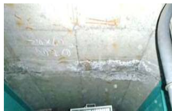
コンクリート床版下面のひび割れ
