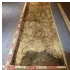
コンクリート床版の土砂化
