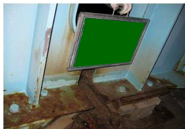
腐食が集中する桁端部
