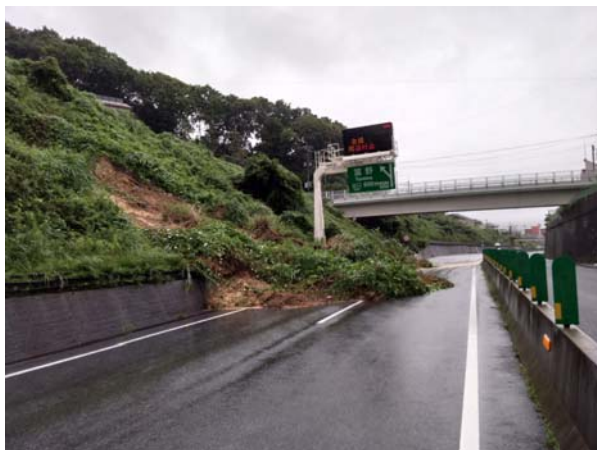
北九州高速 4 号線 大里～富野間 土砂崩れ
