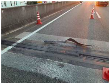
伸縮装置の補強用鋼板 めくれ状況
